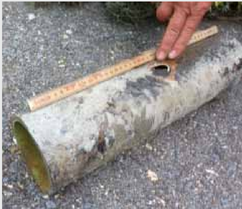
Ducto de agua potable con rotura – vista exterior
