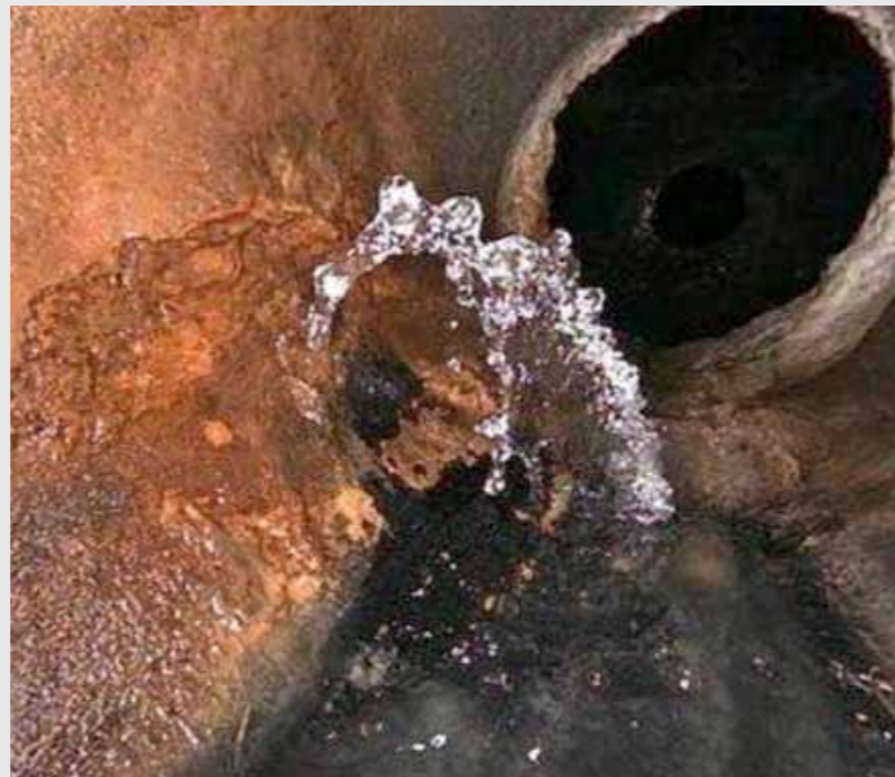
Ducto de agua residual con rotura – vista interior
